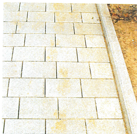
4. Verschmutzung einer Pflasterdecke durch anstehenden Boden.
