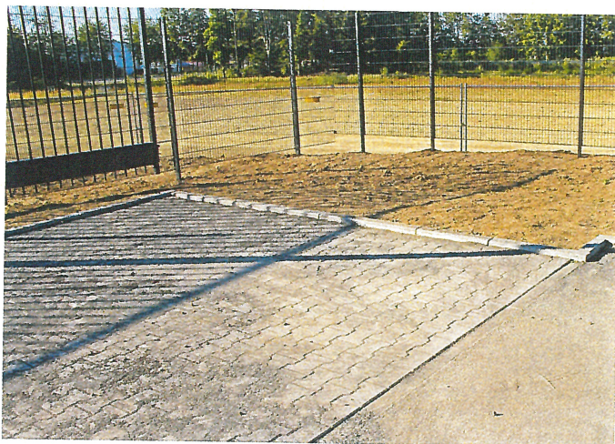
15. Einwirkung von Baustellenschmutz.
